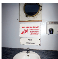
Bild 1: Kein Trinkwasser an Bord
